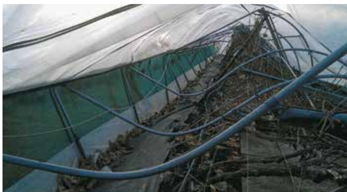
Foto 3: Plasttunnelen med spisedruer kollapsede under snetrykket 23. november. Fotograferet da sneen var tøet og man kunne komme ind og besigtige skaderne. Foto Torben T-A.
